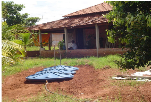
FIGURA 2. Fossa séptica construída por um dos agricultores após um ano da construção da Unidade demonstrativa. Fazenda Monte Alegre. Araraquara
